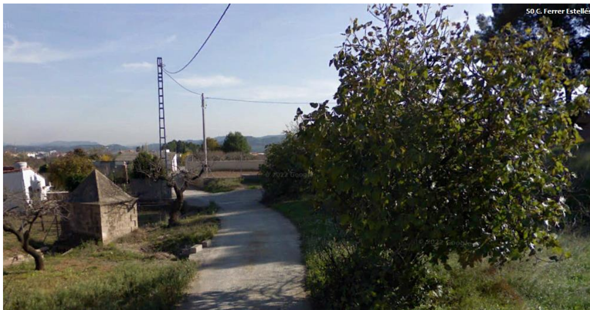
Instalación del nuevo poste P20466-8FVA-250, e inicio de la construcción de la nueva canalización 2C PVC 63 B2 de longitud 15m.
