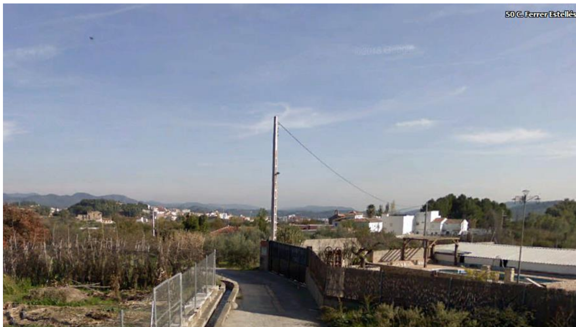
Construcción de la nueva arqueta ARQ-6796-DM y continuación de la nueva Zanja Tritubo 40.
