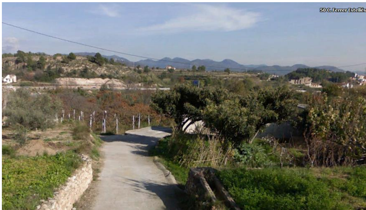
Construcción de la nueva arqueta ARQ-6794-DM y construcción de la nueva canalización 2C PVC 63 B2 de longitud 15m.
